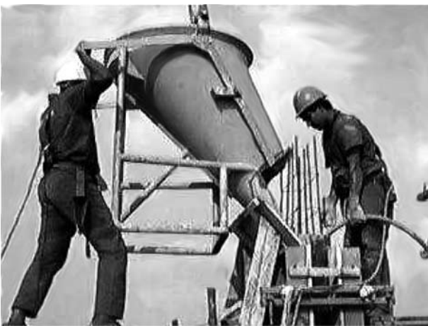
Figura 5: Detalhe de dois operários responsáveis pela moldagem e adensamento de pilar isolado sobre o andaime
