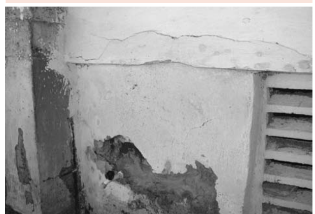
Figura 12: Fissuras longitudinais na direção da armadura na viga de periferia do subsolo
