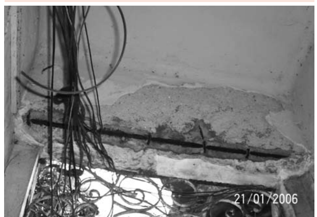
Figura 6: Esfoliação e corrosão de armaduras na viga V02, no 1º pavimento tipo
