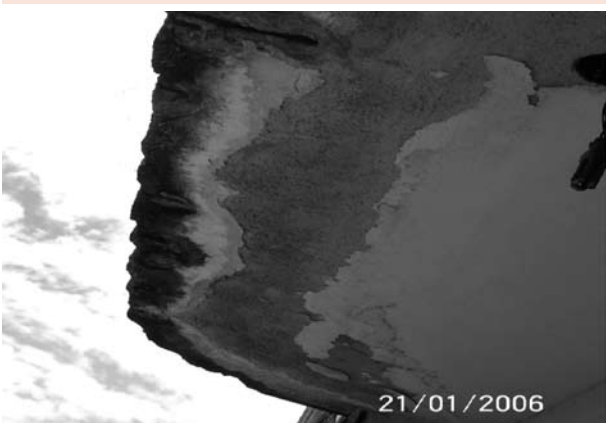
Figura 3: Infiltração generalizada na laje em balanço do 4º pavimento
