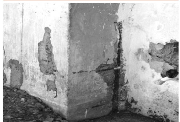
Figura 11: Cobrimento deficiente em pilares do subsolo
