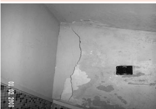
Figura 9: Fissuras de origem térmica na escadaria de emergência
