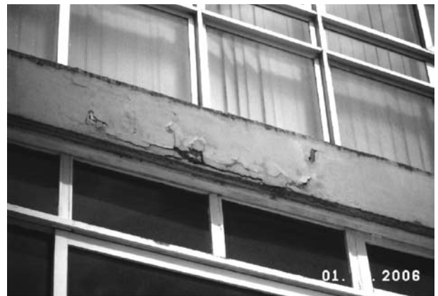
Figura 10: Desagregação do concreto na viga de periferia do 6º andar
