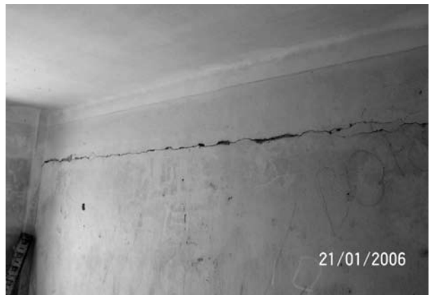
Figura 4: Figura das fissuras na casa de máquinas
