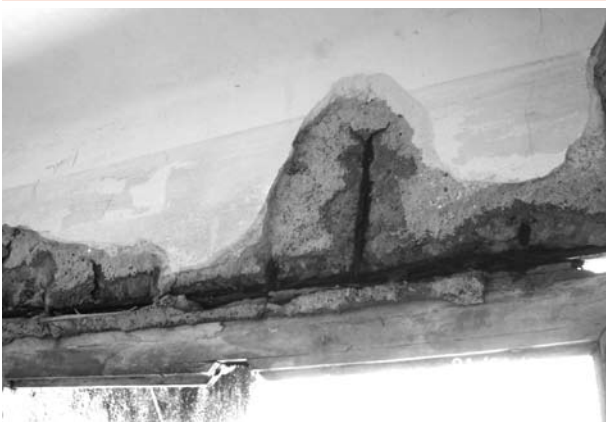
Figura 2: Corrosão acentuada na Viga V06, no 7º pavimento
